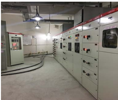
N-4-b 地块配电室
