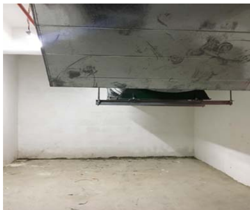
地下车库风机房
