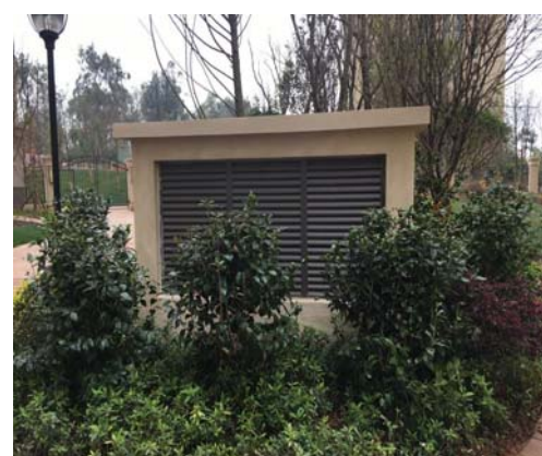
地下车库排气口
